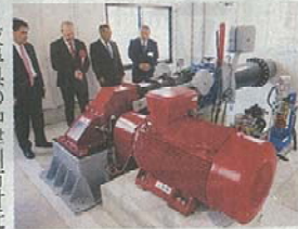
水車・発電機
