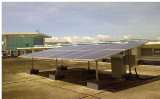
屋上に設置された太陽光発電システム
