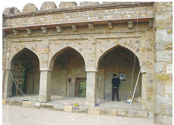
写真-10 オンラインモニタリングデータ送信装置設置状況
