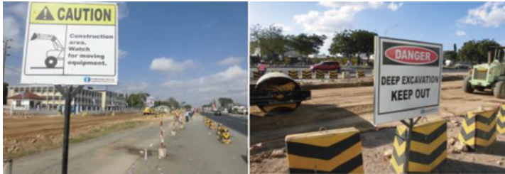
写真-3 工事中の注意を促す標識とコンクリートブロック
