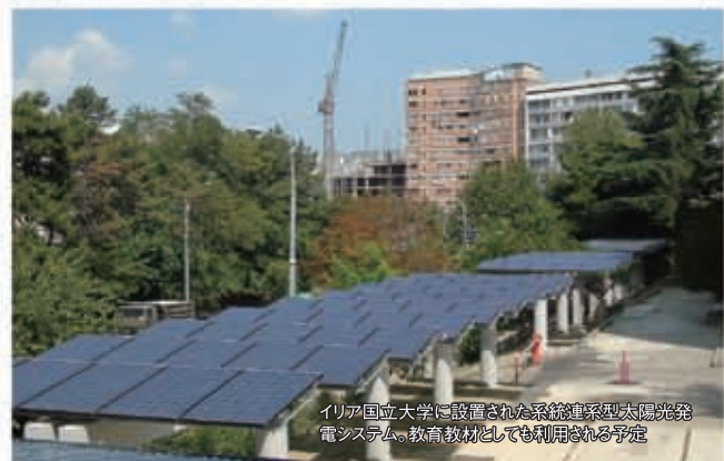
太陽光パネルは架構体の上に設置され、下部スペースは駐車場として利用
