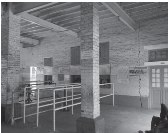
一見、しっかりした造りに見える駅舎の壁にも、天井から床までくっきりとクラックが走っている
