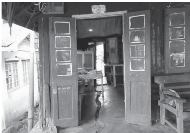
駅舎の床に入った大きなクラックは、地盤が沈んでいる証拠だ
