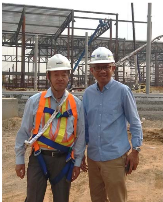
ジャカルタ都市鉄道車両基地建設現場にて (写真左:南條さん、写真右:MRTJ社長 2017年撮影)
