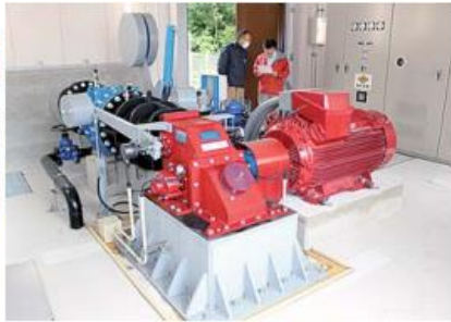
発電機（最大出力193・7キロワット）
