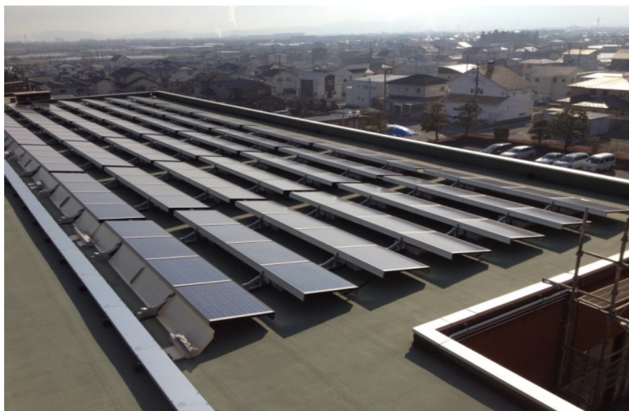
▲太陽光発電施設(南アルプス市)
