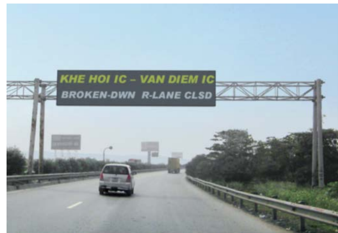
可変情報板(VMS)の設置
