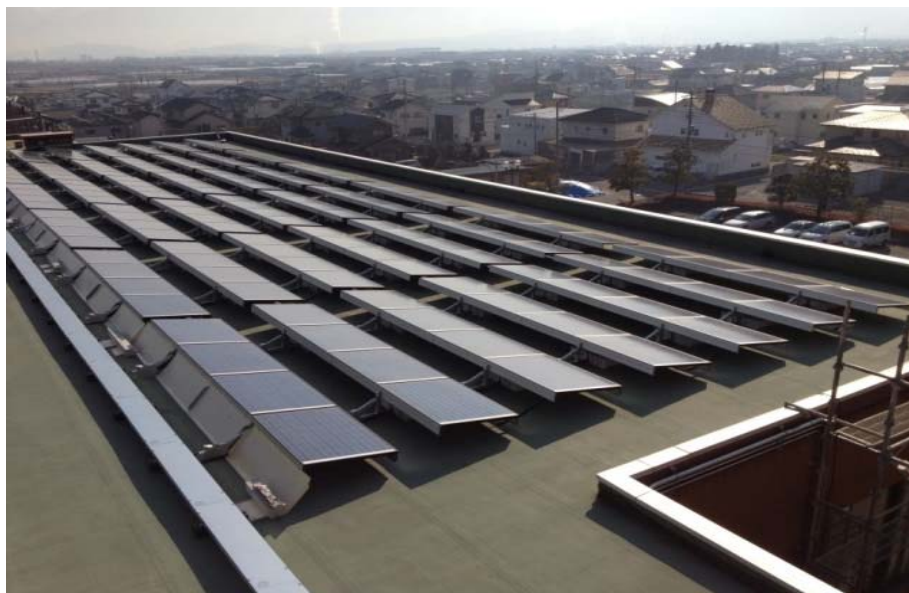
▲太陽光発電施設(南アルプス市)
